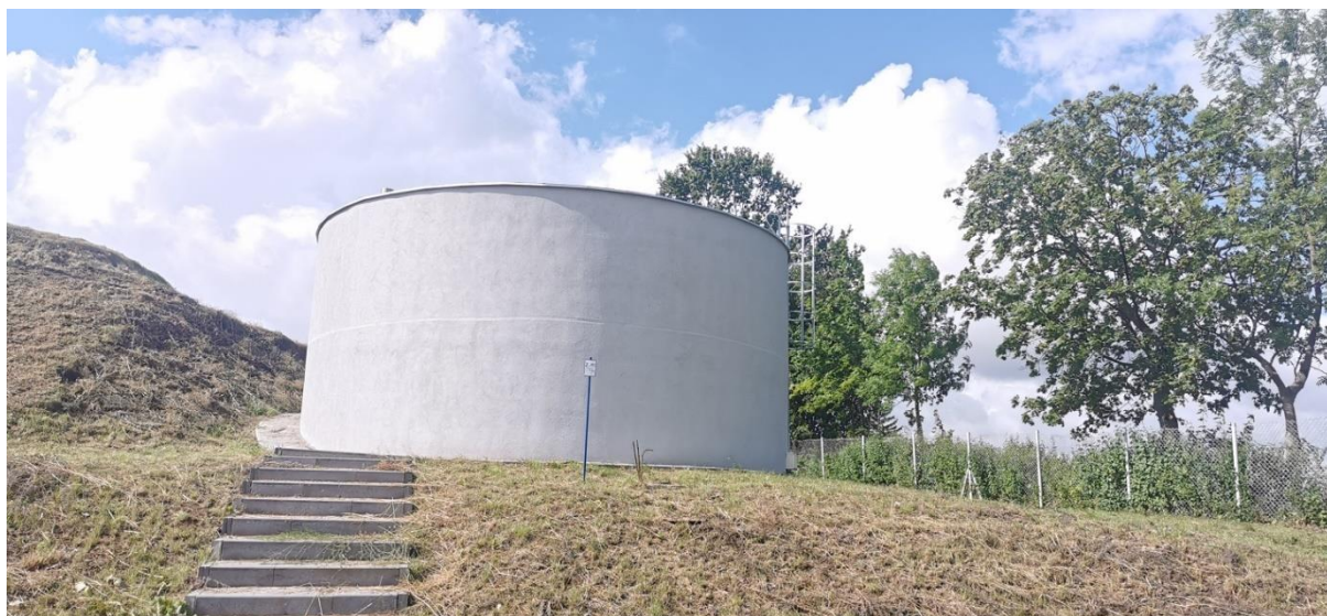
Rysunek 13. SUW w Dębicach zbiornik wody uzdatnionej Źródło: Opracowanie własne
