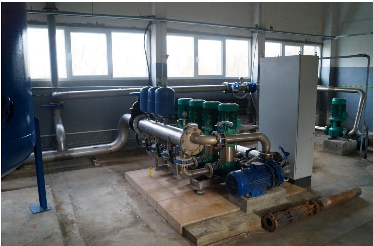
Rys. 30 SUW w Dębicach
