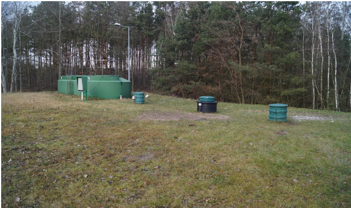
Rys. 32 Oczyszczalnia ścieków w Modzerowie Źródło: opracowanie własne
