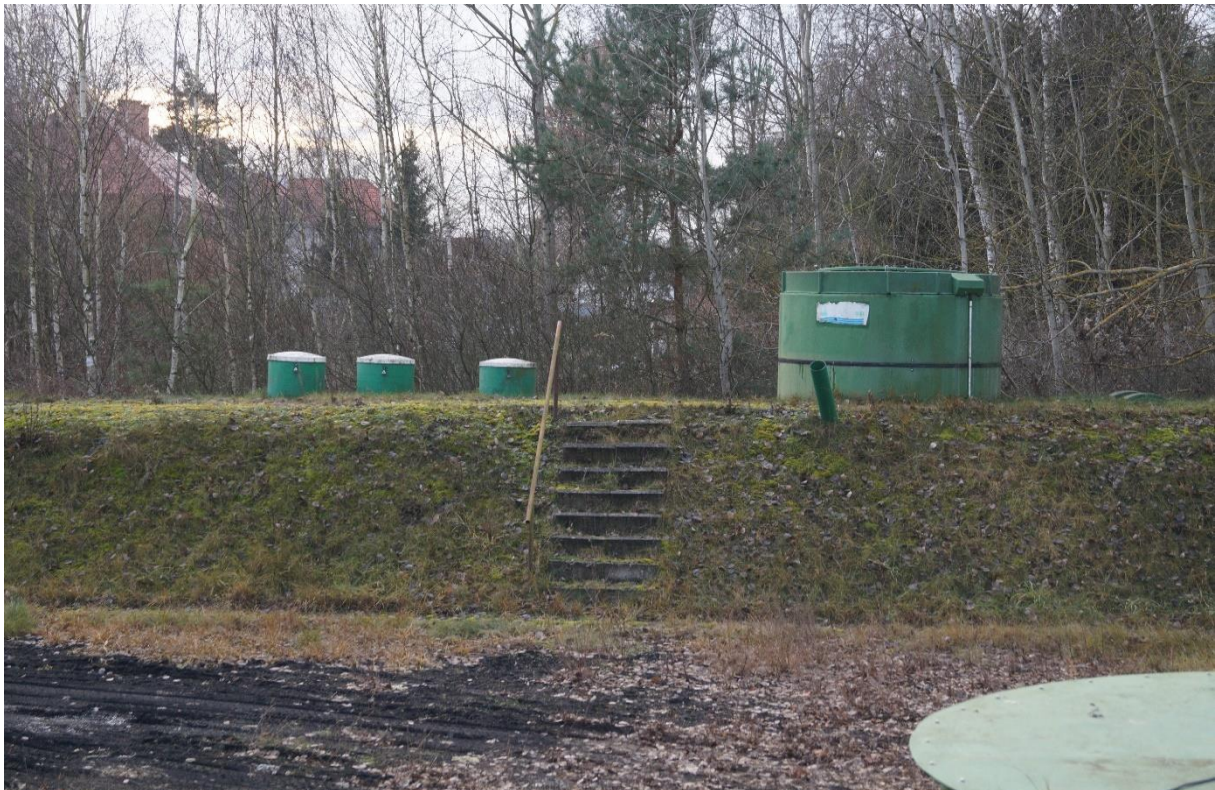
Rys. 33 Oczyszczalnia ścieków w Modzerowie Źródło: Opracowanie własne
