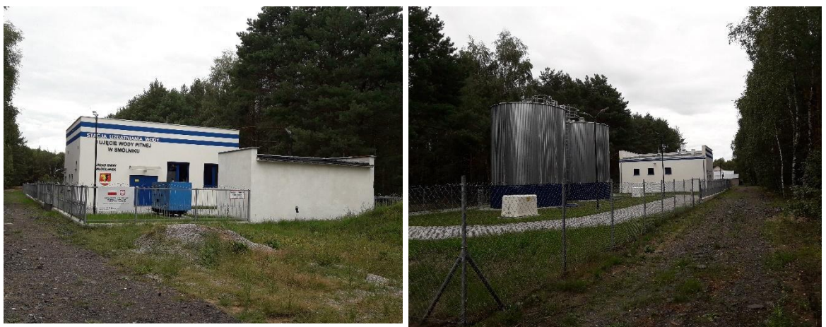
Fot. 20. Smólnik – ujęcie wody ze stacją uzdatniania wody
