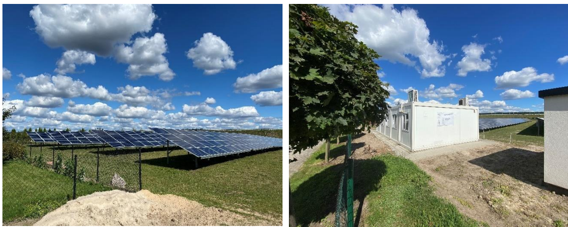
Fot. 22. Nowa Wieś – farma fotowoltaiczna wraz z magazynem energii Źródło: fotografia własna
