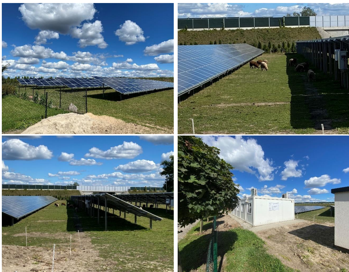
Fot. Nowa Wieś – farma fotowoltaiczna wraz z magazynem energii
